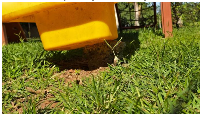
Foto 6 – Detalhe da base sem fixação adequada ao solo
