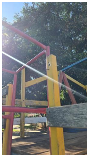
Foto 2 – Rachaduras e apodrecimento na madeira da estrutura
