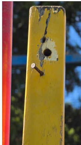
Foto 3 – Prego enferrujado exposto — risco imediato de ferimento
