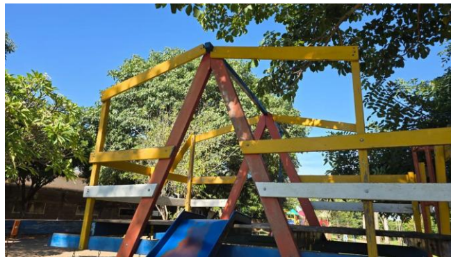
Foto 1 – Estrutura geral com madeira deteriorada e tinta descascada
