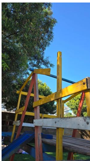
Foto 8 – Vista geral da estrutura deteriorada
