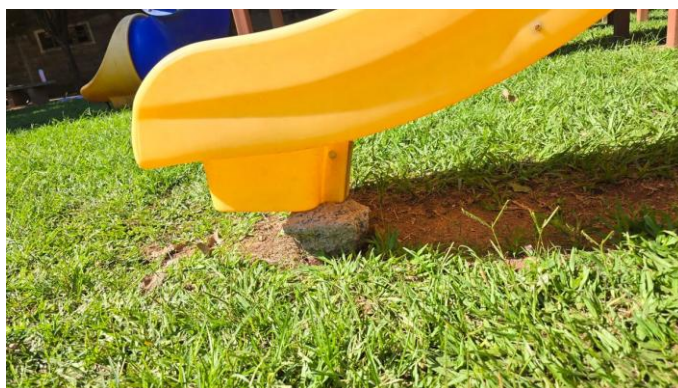
Foto 5 – Base do escorregador apoiada sobre pedra solta, sem fixação
