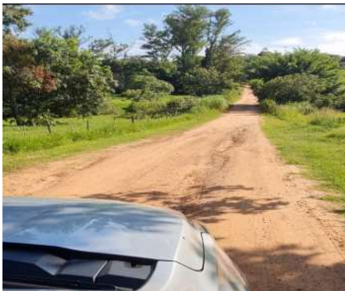
Formação de erosão nas estradas.
