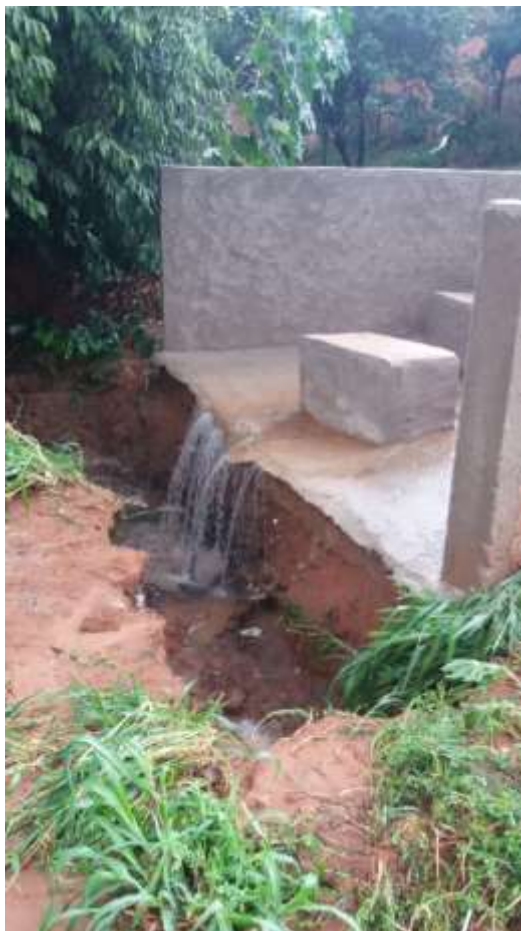
Dissipador construído para as águas que escoam da Rua Cedro, com erosões ameaçando sua estrutura
