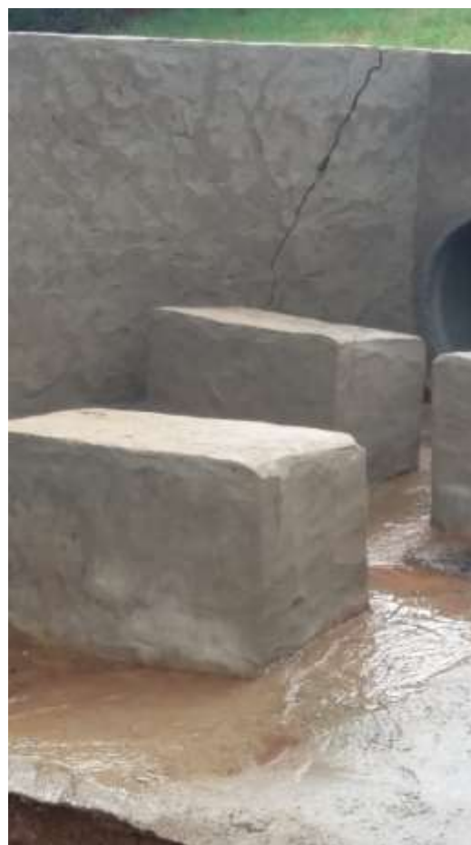
Parte interna do Dissipador com Rachaduras em sua Estrutura pouco tempo após sua construção
