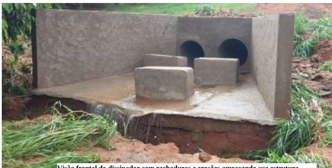
Visão frontal do dissipador com rachaduras e erosões ameaçando sua estrutura.
