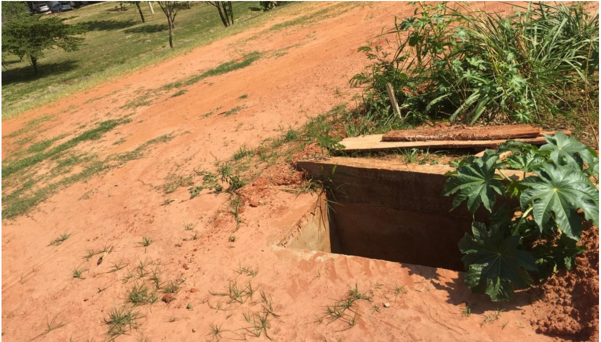
Galeria desprovida de tampa, em obra privada, na Rua Juruva, onde aos fundos faz divisa com a pista de caminhadas do Parque Caldeira
