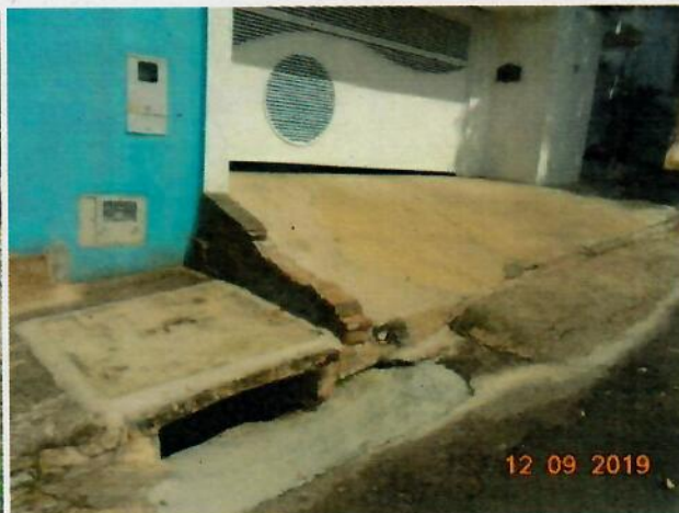
Foto 06 – Boca de Lobo simples existente no outro lado da Rua Pinheiro.
