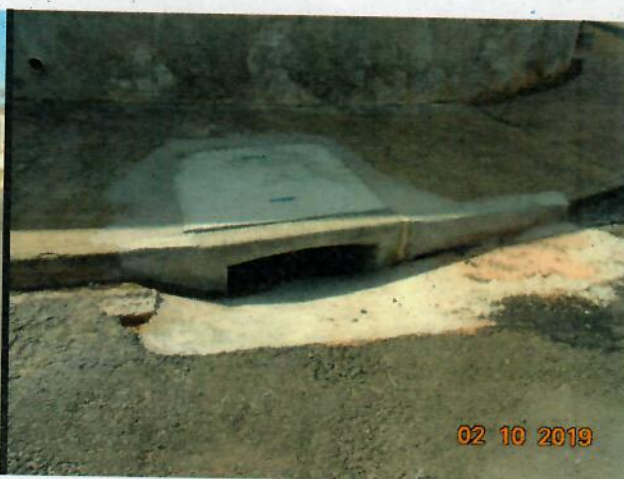
Foto 16 – Boca de lobo simples executada na Rua Cedro, anterior à confluência com a Rua Cabreúva.
